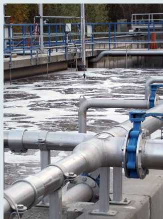
Air ( \text{O}_2 ) – aération des bassins d'effluents (installations de traitement des eaux usées)
