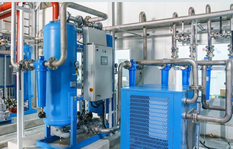
Air comprimé – services de distribution d'énergie
