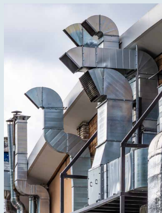
Air – air neuf dans les conduits de ventilation
