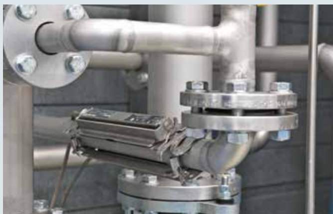
Mesures de remplacement pour les débitmètres défectueux
