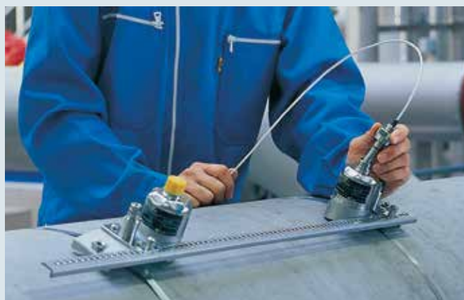
Vérification des débitmètres installés
