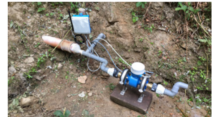
Měření vydatnosti pramene pomocí bateriově napájeného průtokoměru Promag W 800
