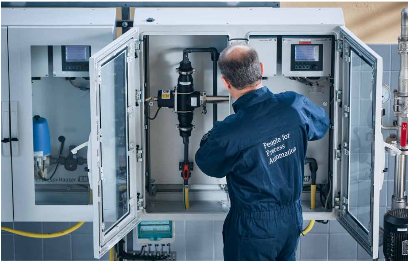
Die Messtechnik für Kritische Kontrollpunkte (CCPs) wird oft auf einem Panel installiert. Manchmal wird zum Schutz der Messtechnik auch ein Umschrank genutzt. Unsere Serviceingenieure helfen Ihnen gern bei der Installation und Wartung Ihrer CCPs.
