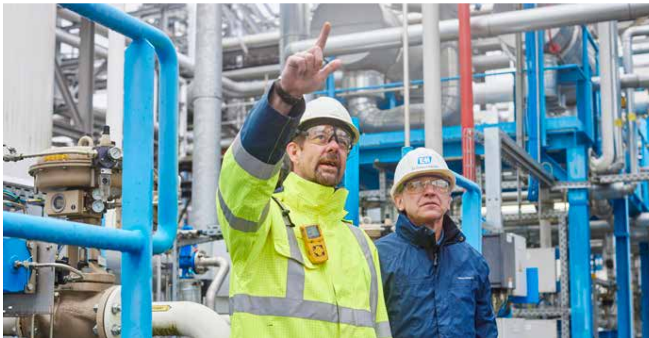
Guido Kniepper, directeur de l'usine, avec un employé d'Endress+Hauser sur l'usine de production d'hydrogène.
