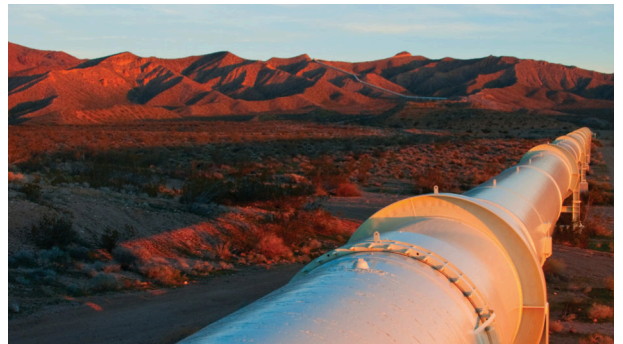
Taşıma boru hatları (miktar ölçümü, sızıntı tespiti)
