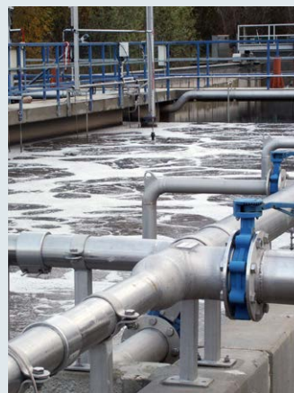
空気( \text{O}_2 ) - 活性汚泥槽の曝気 (下水処理場)
