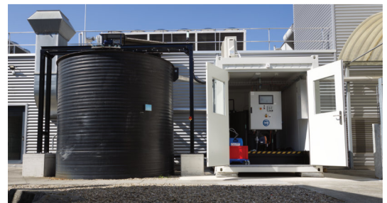
Kompaktneutralisation im Container und Stapeltank mit Rührwerk
