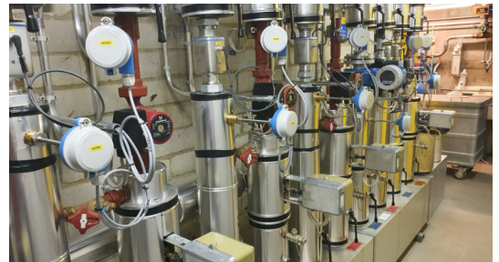
Energiemessung im Keller des Schulhauses
