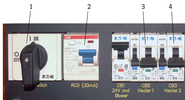
Fig. 66 - Interruttore generale e fusibili nell'unità di controllo
