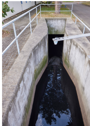
Mesure de débit intégrée
