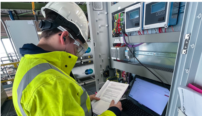
Endress+Hauser Servicetechniker nimmt den Energieberechner EngyCal RS33 für Dampf und EngyCal RH33 für Flüssigkeiten zusammen mit dem Datenmanager Memograph M RSG45 in Betrieb
