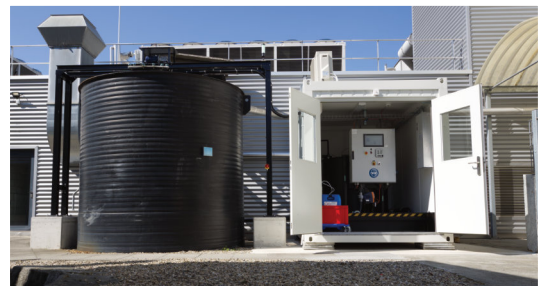
Neutralisation compacte dans un conteneur et un réservoir empilable avec agitateur.
