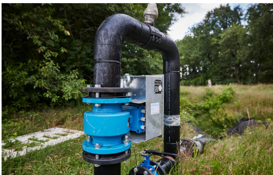
Promag W 800 misst die Menge an Grundwasser.
