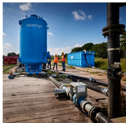
Einsatz von Eisenfiltern zur Wasseraufbereitung (Entfernung von Eisen aus dem Wasser).
