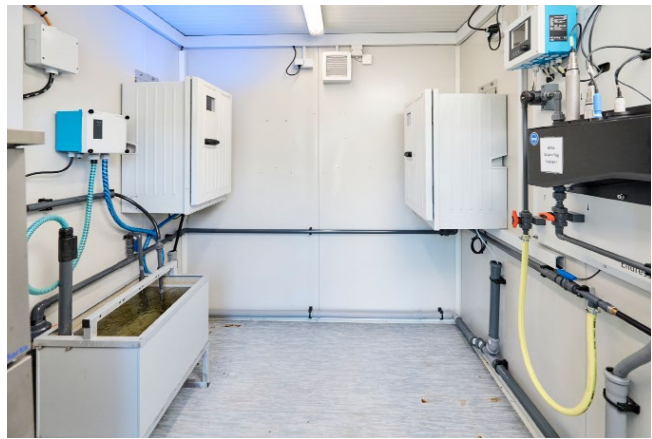
Messcontainer mit Analysatoren und Analysepanel zur Auslaufüberwachung der Kläranlage
