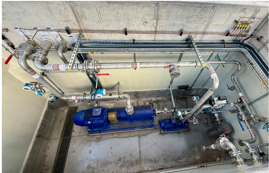
Methanol Abfüllanlage mit verschiedenen Endress+Hauser Messgeräten zur verlässlichen Überprüfung und Steuerung
