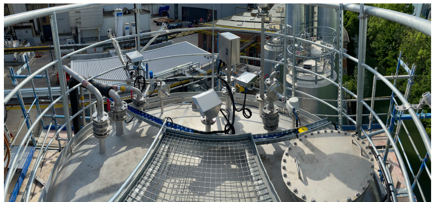
Endress+Hauser Messequipment zur Überprüfung verschiedener Messaufgaben auf dem Methanol-Lagertank
