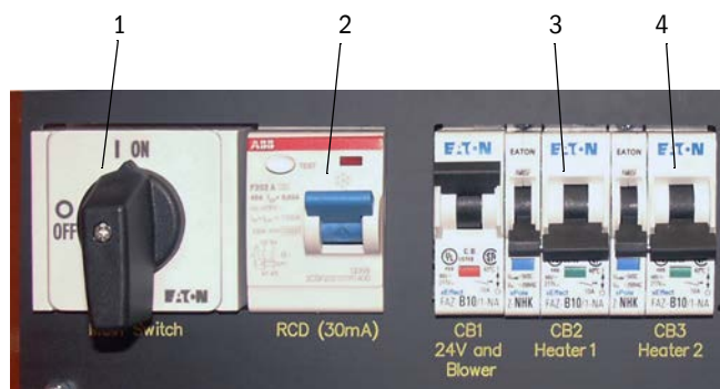
Kuva 66: Pääkytkin ja sulakkeet ohjausyksikössä
