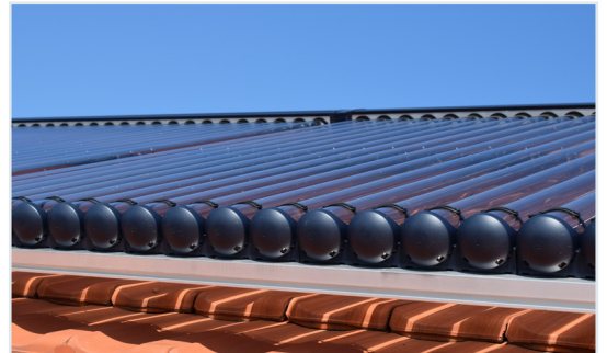
Impianto solare termico
