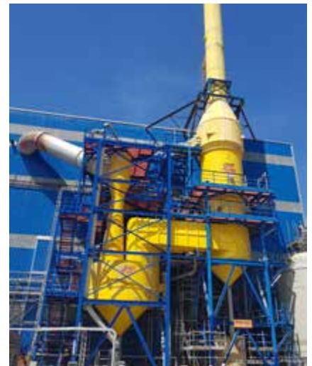
Gaswäscher bei Rosier am Standort Sas van Gent
