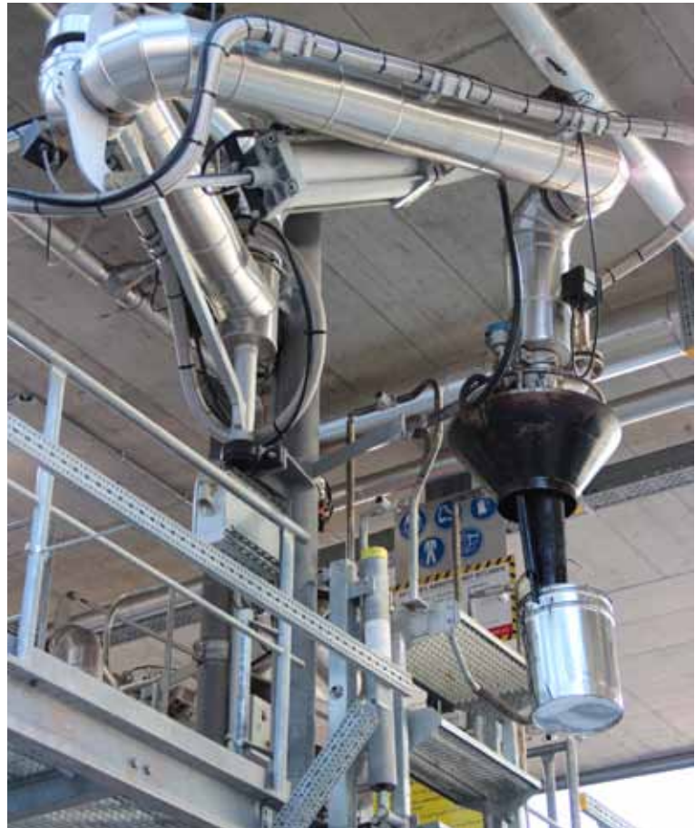
Lkw-Verladevorrichtung für flüssiges Bitumen
