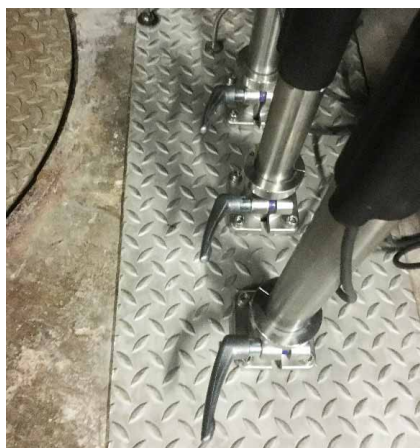
Três sensores instalados
