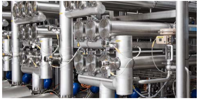
Membraninstallation zur Molkeverarbeitung
