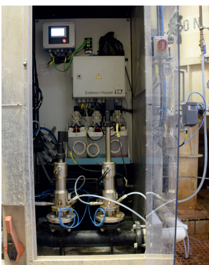
Liquiline Control CDC90 op de achtergrond in omkasting met 2 stuks pneumatisch bedienbare terugtrekkende armaturen voor pH-sensoren aan voorzijde.
