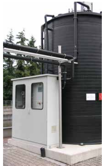
Station de précipitation à la station d'épuration Breuberg-Hainstadt (ci-dessus), débitmètres pour le dosage du réactif (à gauche)
