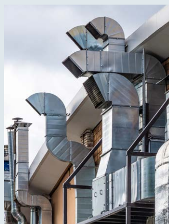
空気 - 換気ダクトの外気
