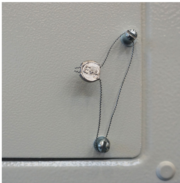
Fig. 27 Parafusos selados com fio de selamento
