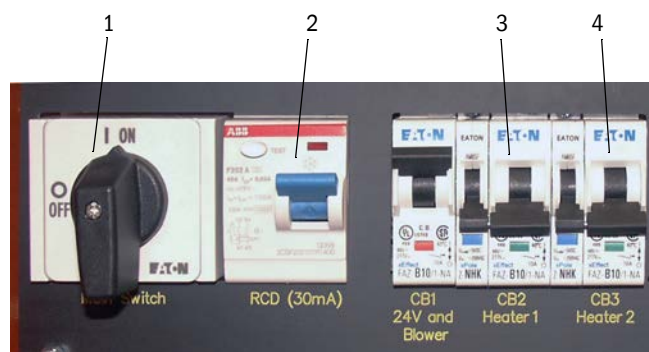
Abb. 66: Hauptschalter und Sicherungen in der Steuereinheit
