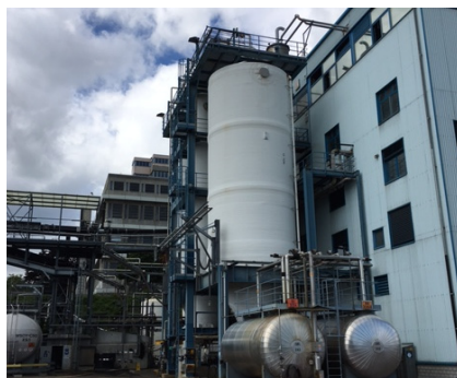
Cuve pour la préparation des eaux usées.
