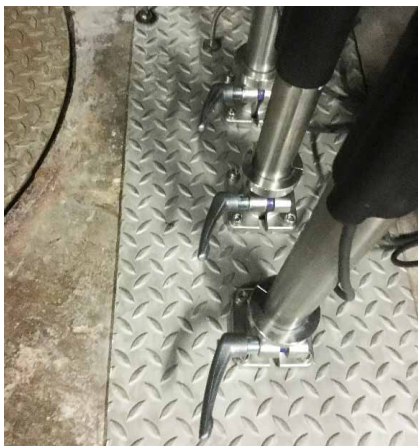
Trois sondes montées sur l'installation
