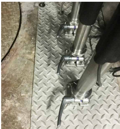
Trois sondes montées sur l'installation
