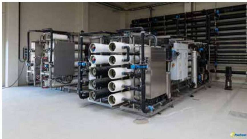
Umkehrosmoseanlage im Werk von Pasfrost.
