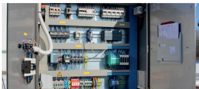
Im Schaltschrank vor Ort werden die Signale verarbeitet und weitergegeben
