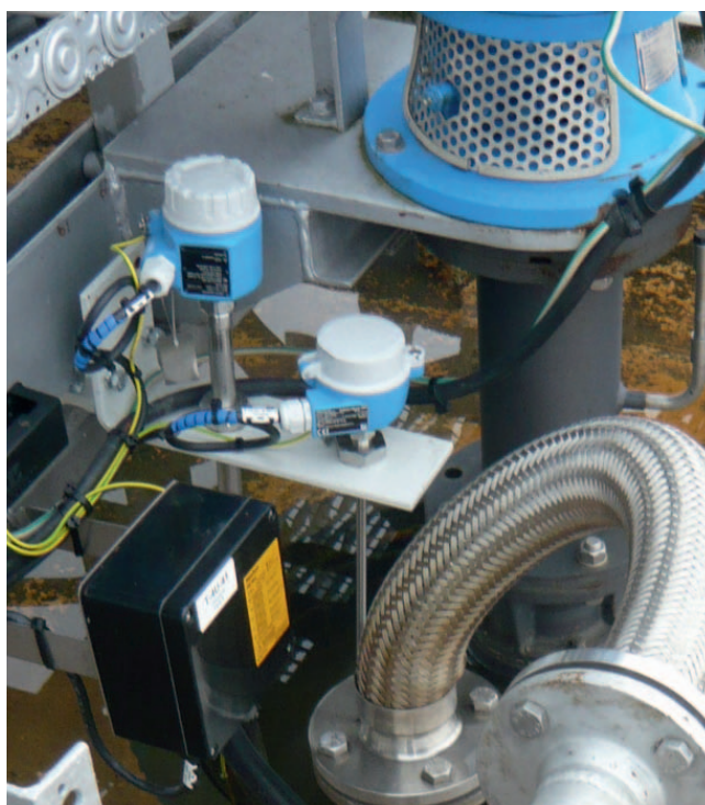
Grenzstanddetektion und Temperaturmessstelle auf dem Schwimmdach
