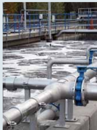
Luft ( \text{O}_2 ) – Belüftung in Belebtschlammbecken (Abwasseranlagen)
