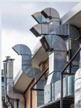
Luft – Frischluft in Lüftungsschächten
