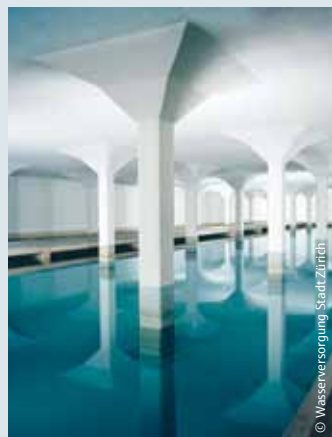
Ozon ( \text{O}_3 ), Chlor ( \text{Cl}_2 ) – Desinfektion von Wasser
