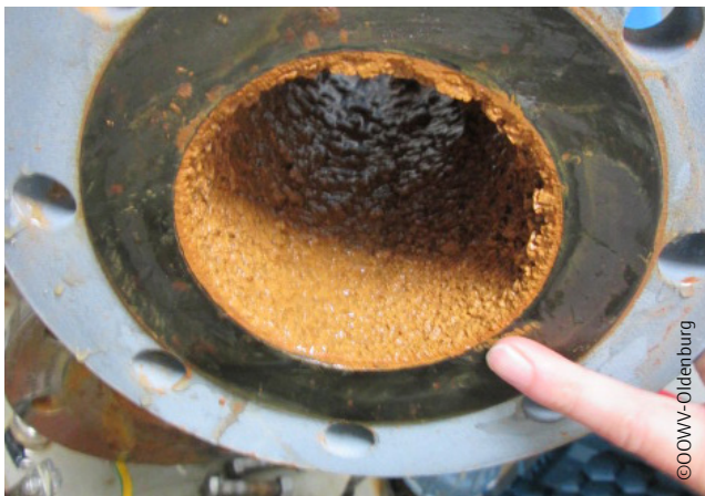
Belagsbildung von Eisenhydroxid und Manganoxid über 12 Monate hinweg
