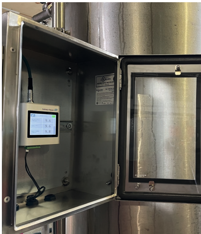
Der Messumformer von Teqwave H ermöglicht vor dem Produktwechsel ein einfaches Umstellen der Rezepte – direkt in der Anlage oder via Laptop
