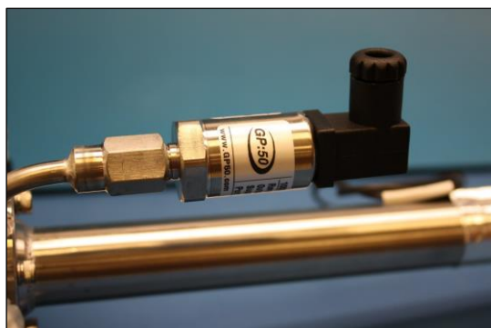
Fig 43. Posicionamento do novo sensor de pressão instalado.
