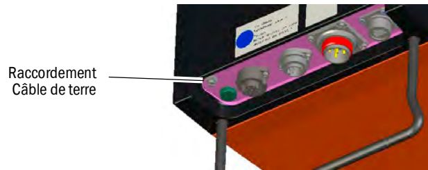
Fig. 21 : Raccordement du câble de terre sous l'E/R
